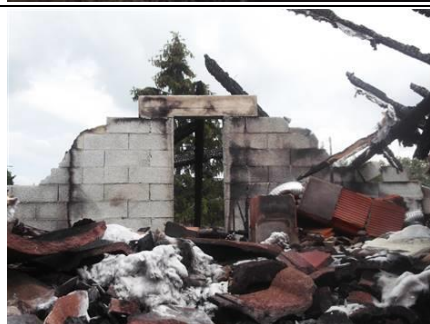
Photo n° PhA022 Localisation : 2ème étage - Combles Ouvrage : 5 - Planchers et planchers techniques - Revêtements de sols Partie d'ouvrage : Planchers Description : Gravats
